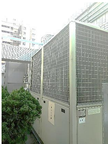
圖2-211：新莊分館氣冷式冰水主機1號機
