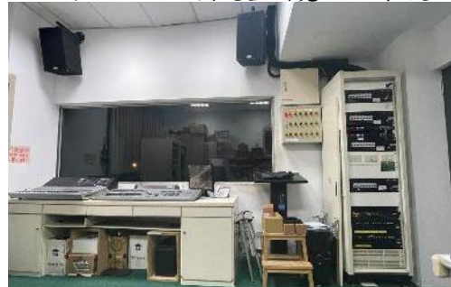
圖2-10-182 演藝廳控制室-增設設備後
