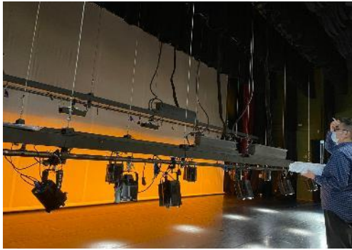
圖2-10-183 演藝廳-LED燈光設備
