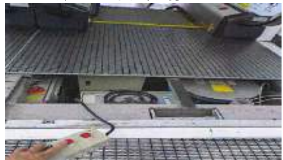
圖2.6.18- 總館電梯、電扶梯維養
