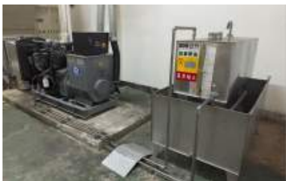
圖2.6.9-板橋四維分館緊急發電機更新
