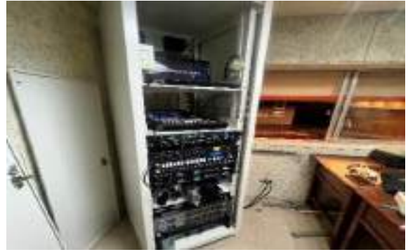
圖4.2.4- 音響、麥克風、擴大機及數位混音座等設備更新
